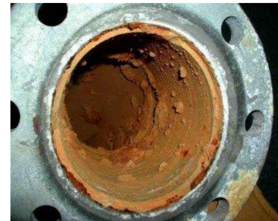
図48-11 腐食事例(ほぼ10年経過した亜鉛めっき鋼管の内面) (kitanet)
