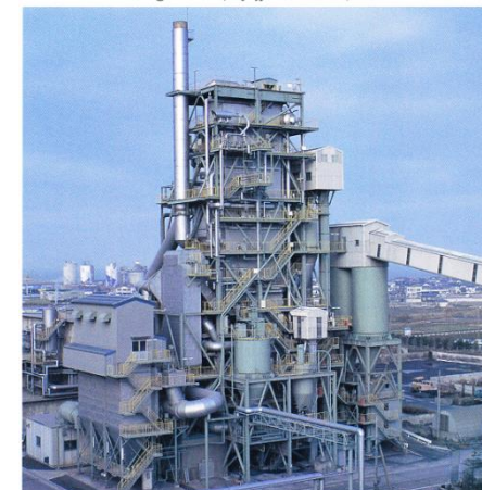
図42-18 循環流動層ボイラ (JFE)
