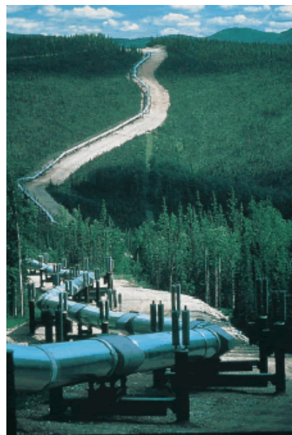
図25-14 寒冷地の天然ガスパイプライン
