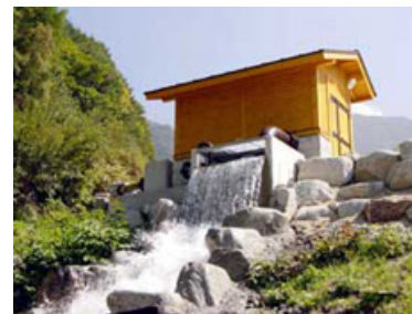
図7-11 長野県上松町 滑川砂防公園6kw小水力発電
