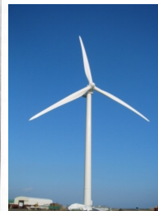
2400キロワット級風車の「MWT92/2.4」。翼部分の直径は92メートル
